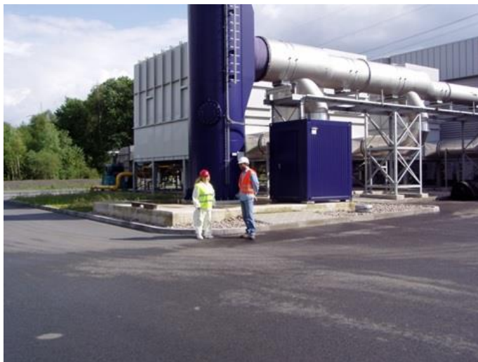
Εξωτερική εγκατάσταση μονάδας επεξεργασίας στερεών αποβλήτων που παράγει ηλεκτρική ενέργεια
